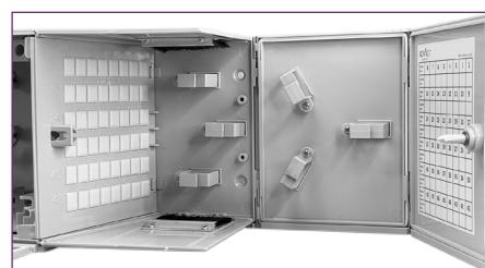
Detalle de separador donde se ubican los adaptadores
