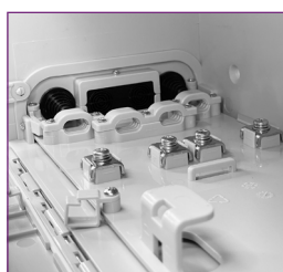
Detalle fijación cables entrada
