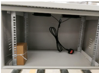
Grupo de ventilación
